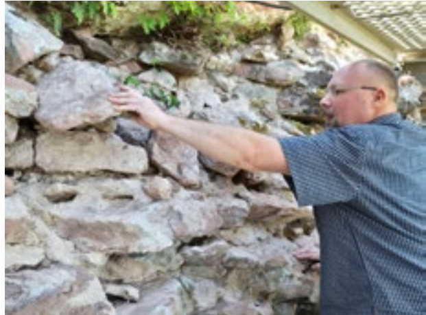
Marc Sattel zeigt lose Steine im Mauerwerk.
